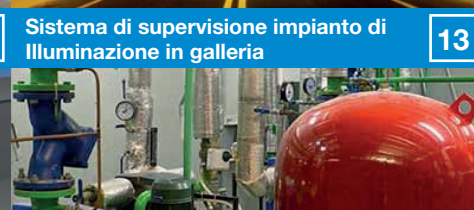
Telecontrollo centrali termiche
