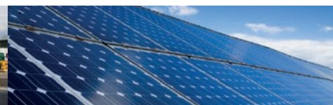
Sistema di telegestione impianti fotovoltaici
