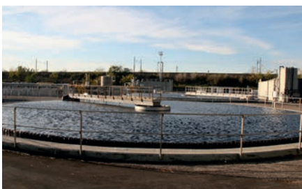
Impianti di Depurazione
