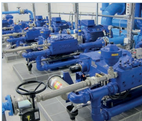
Controllo stazione di pompaggio o gruppo di pressurizzazione
