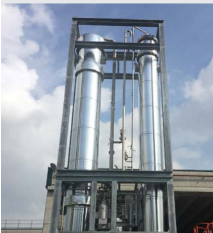
Unidade de Upgrading GM-GreenMethane por 125 Smc/h biometano
