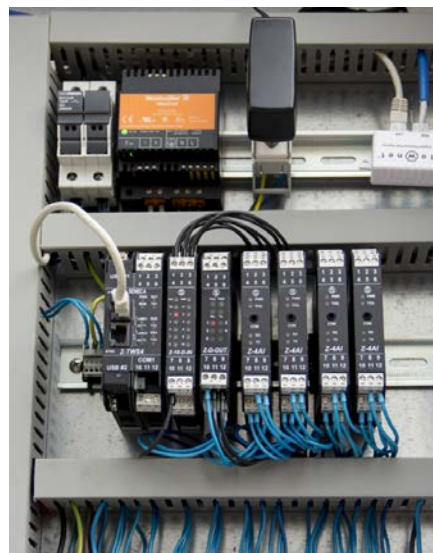
Detalhes do quadro de dispositivo
