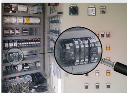
Quadro de controle e comando para as passagens subterrâneas com hardware SENECA e redundâncias eletromecânicas
