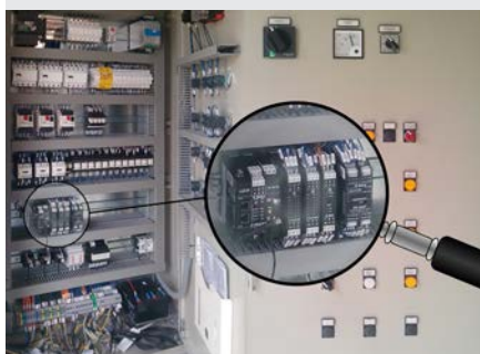
Panneau de commande et de contrôle pour sous-voies avec matériel SENECA et redondances électromécaniques
