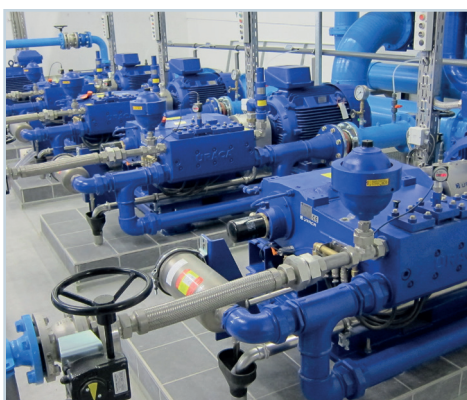
Contrôle station de pompage ou groupe de pressurisation
